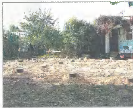
Оголовки залитых опор фундамента располагались на высоте 15 см от уровня грунта, но участок имеет уклон
